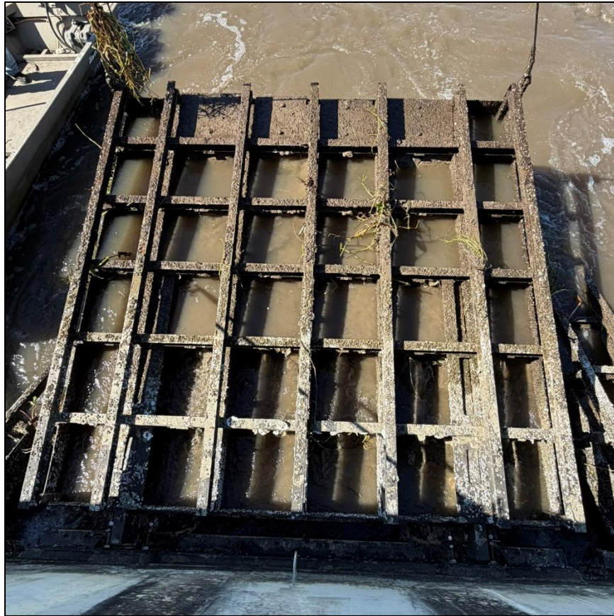
9a. Gate No. 9 – Top View
